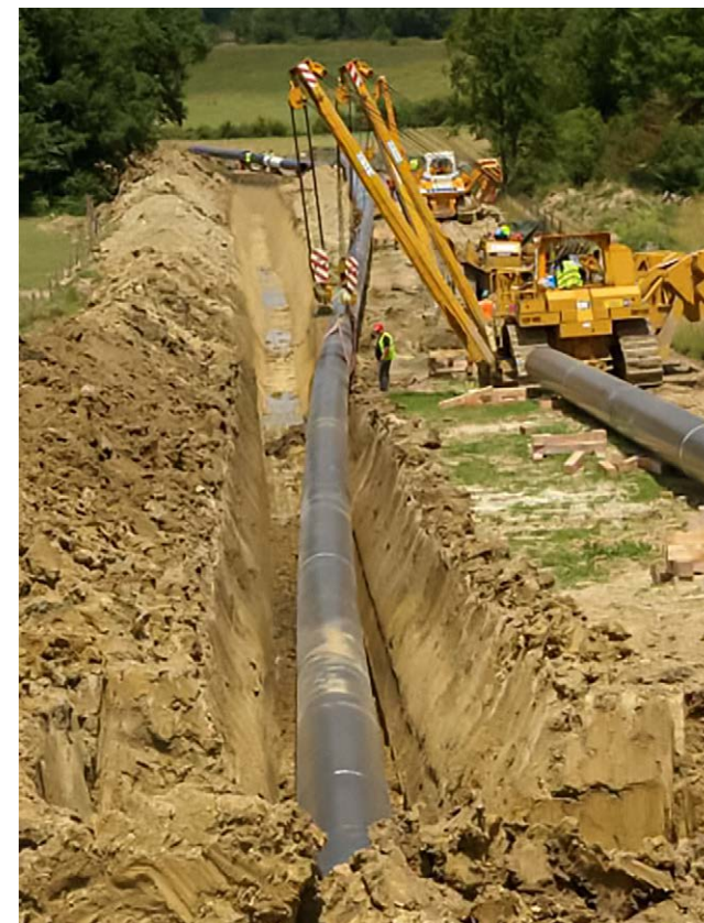
Mise en fouille d'une canalisation de transport de gaz naturel (diamètre 1200) (source : GRTgaz)
