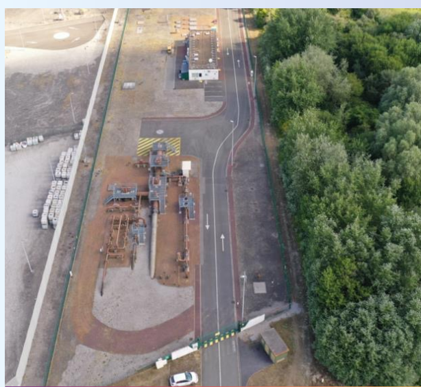
Station d'odorisation de Loon-Plage
